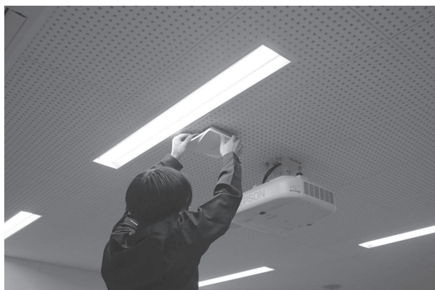
無線 Wi-Fi 整備
